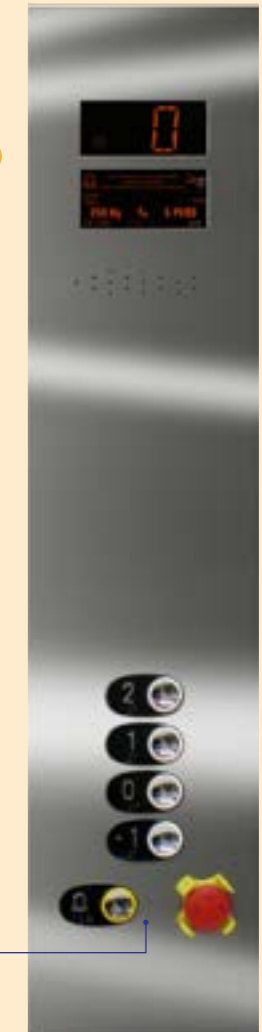
BOTÕES E PAINEL DE COMANDO DA CABINA
